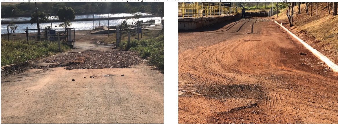
Figura 1: Imagens dos trechos a serem recuperados, em julho de 2019.
